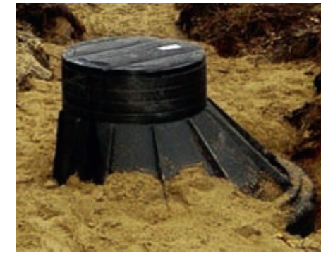
Фото 43. Вариант применения сварной полиэтиленовой крышки
